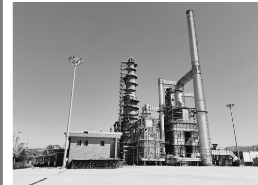
中石油兰州石化公司厂区550万吨/年常减压装置。
