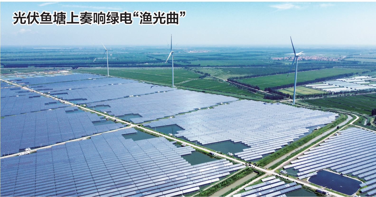
这是在天津市宁河区宁河镇大月河村拍摄的110千伏大月河光伏电站(7月18日摄,无人机照片)。当日,位于天津市宁河区宁河镇大月河村的110千伏大月河光伏电站迎来集中年中检修。该光伏电站总装机容量80兆瓦,建设在约3000亩的鱼塘上,让鱼塘形成了“水上发电、水下养鱼”的绿色生态养殖模式,极大提高单位面积土地的经济价值。每年还以土地流转的方式让村民增收,进一步助力乡村振兴。
